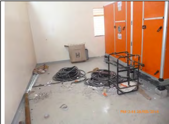
AHU Room (Before)
